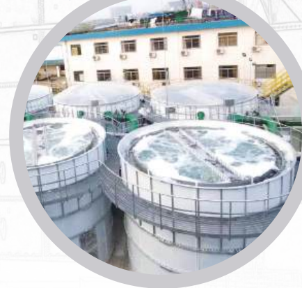
曝气生物滤池
